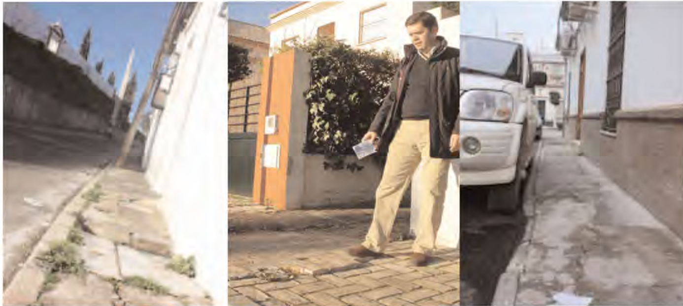
Pésimo estado del asfalto y acerado de la C/ Joaquín Benavente
